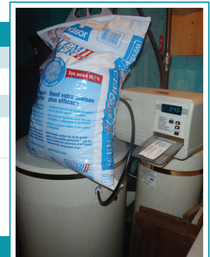
Les sels dissous peuvent nuire au fonctionnement d'un système d'égout privé.
