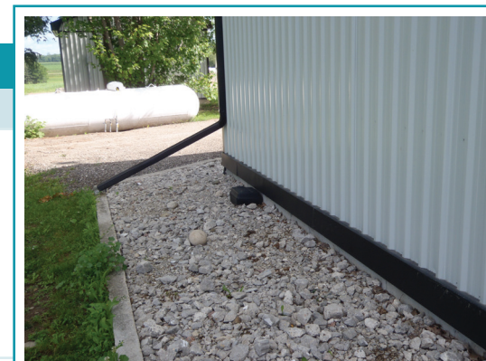
Les gouttières et les drains de fondation et de semelle doivent être des systèmes séparés sans aucun lien avec le système d'égout.
