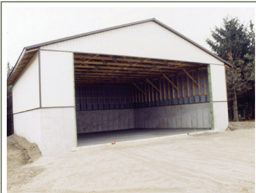
La meilleure façon d'empêcher l'eau de pluie de pénétrer dans l'aire de mélange et de chargement consiste à recouvrir cette dernière d'un toit permanent.
