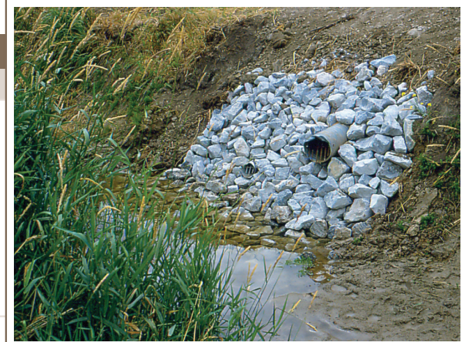
Des sorties de drainage bien placées et bien conçues permettent de prévenir l'érosion des berges et de maintenir la stabilité des bouches de drain.
