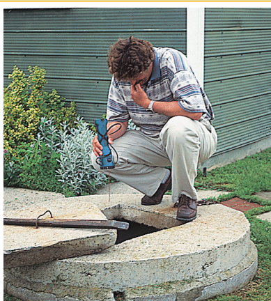
L'inspection du bouchon doit faire partie du programme d'inspection annuelle du puits.
