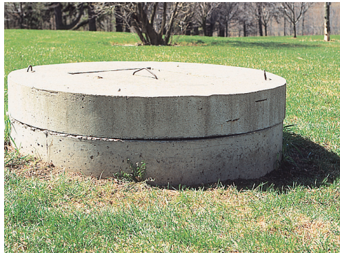
Les puits creusés ou forés à la tarière dont les couvercles sont en béton sont considérés comme étant pourvus d'un événement.
