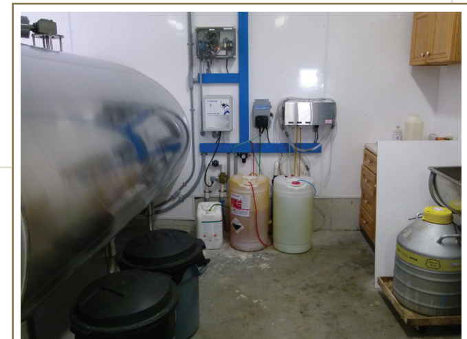
L'utilisation excessive de produits chimiques coûte cher. L'analyse de l'eau et la vérification du matériel peuvent permettre de réaliser des économies.
